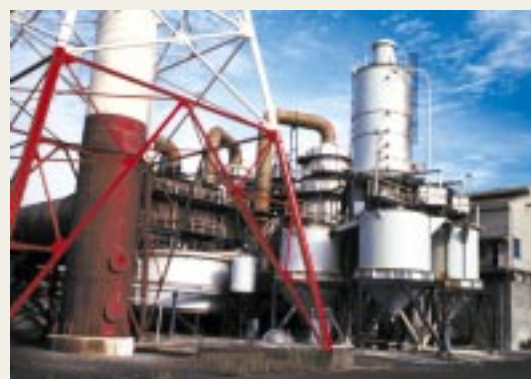
排煙脱硫装置 当社の公害防止技術の中で、高い評価をうけている「同和方式排煙脱硫プロセス」
