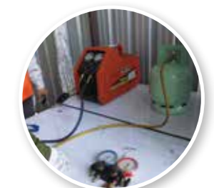
フロン回収システム
