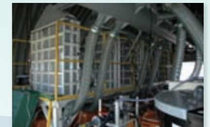
パイロット試験処理装置(セレン排水処理)
