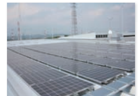
ソーラーパネル (太田新工場)
